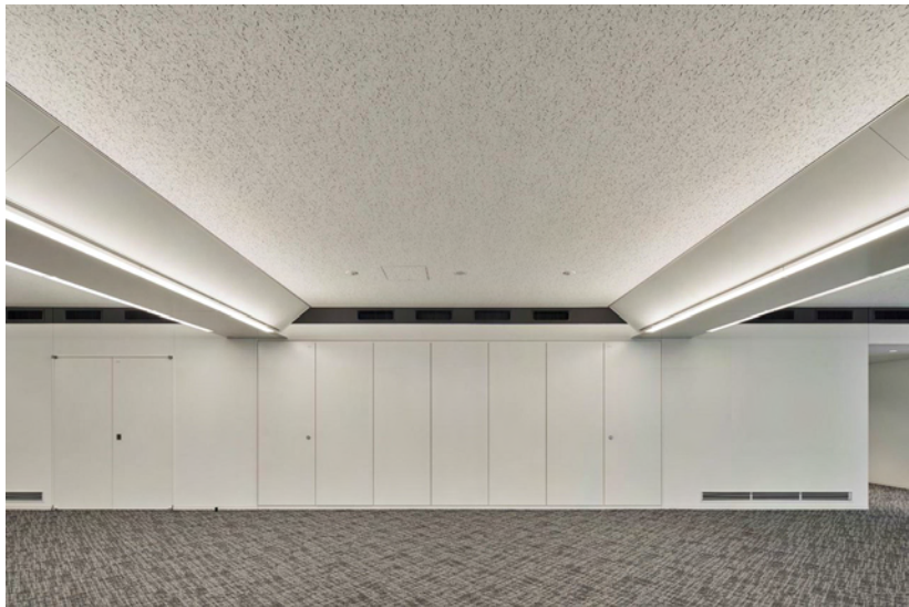
「Air-Soarer」による変風量コアンダ空調(3-5階)
