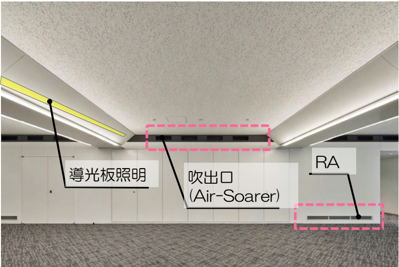
「Air-Soarer」による変風量コアンダ空調(3-5階)
