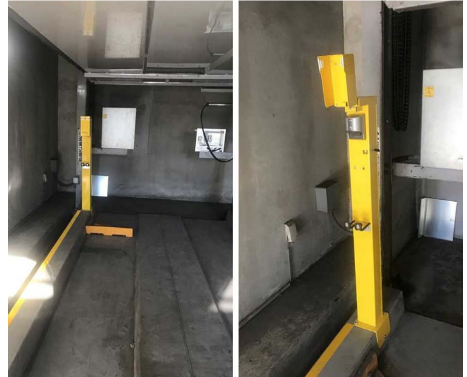
充電器付きの機械式駐車場(左) パレット上の専用コンセント(右) (写真提供:ユアスタンド(株))
