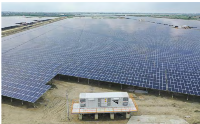
再エネプラント向け 電気機器
